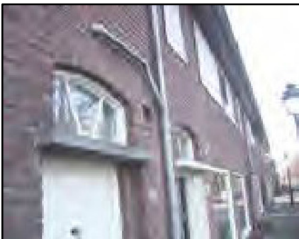
Figuur 1: Een foutieve aansluiting van een badkamer op regenafwatering.
